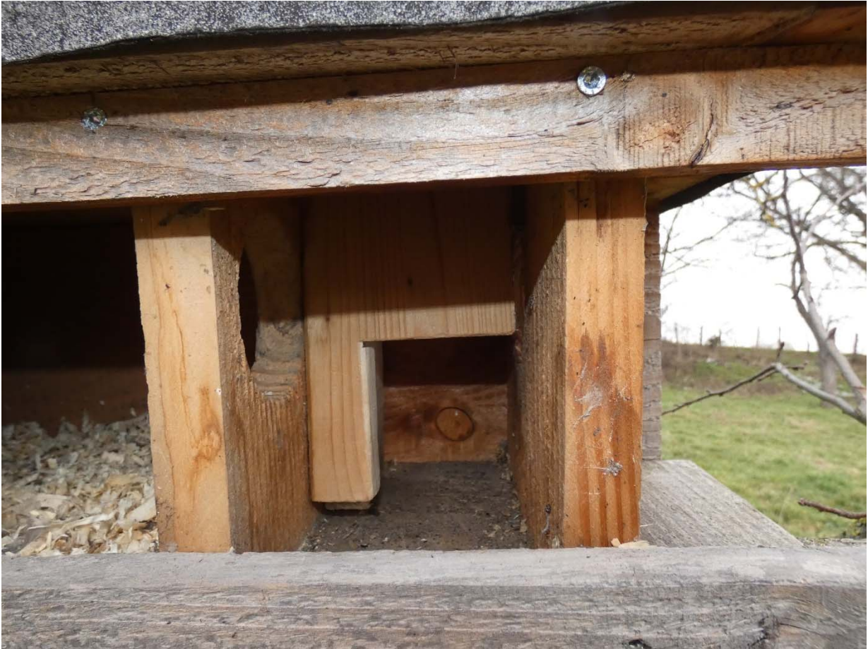
Abbildung 5: nachträglich mit einem Zwischenbrett angebrachter Marderschutz mit „Nase“; der Vorraum ist 10 Zentimeter breit
