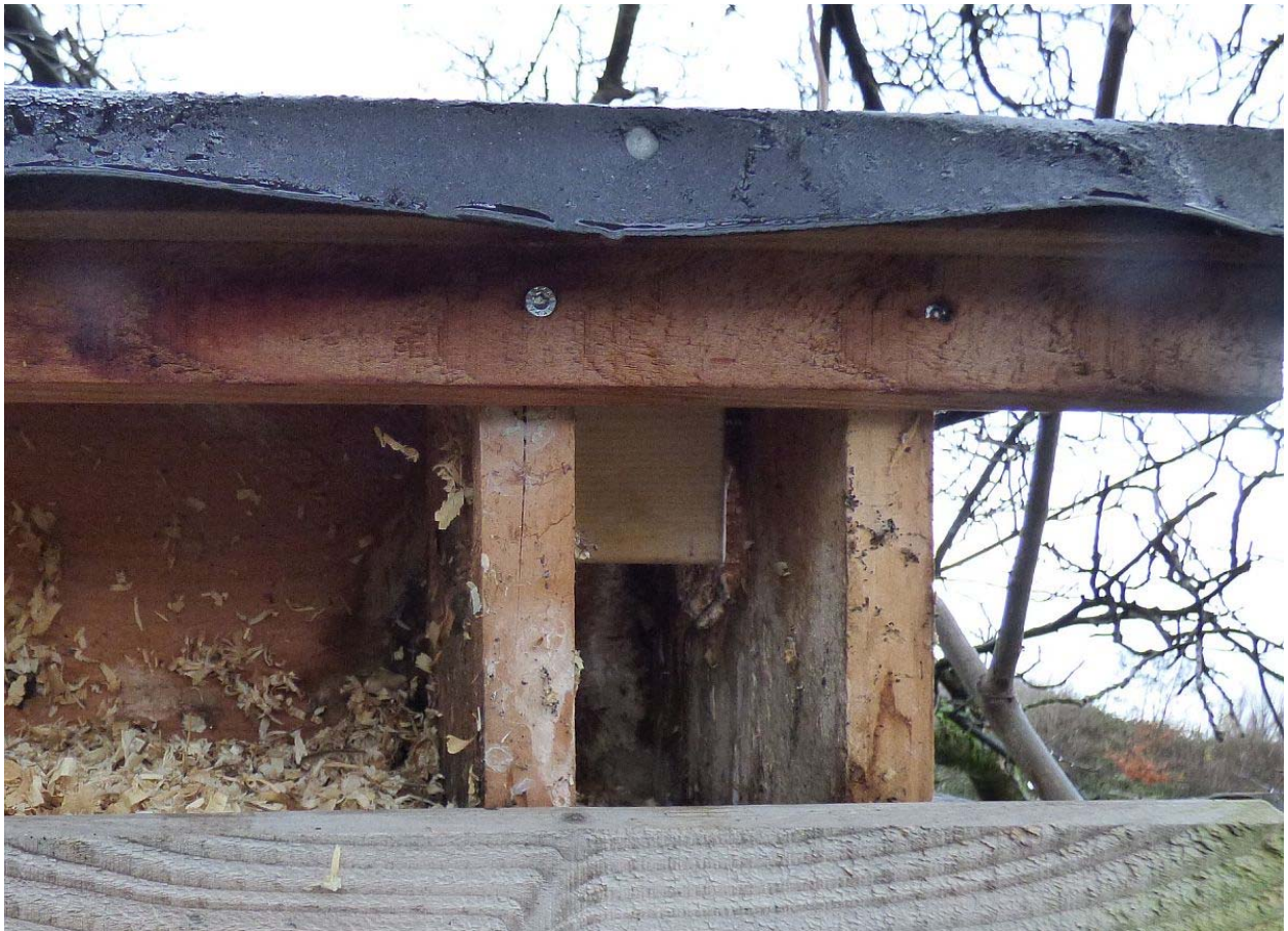
Abbildung 6: schmalerer Vorraum mit nachträglich angebrachtem 7 cm breitem Marderschutzz
